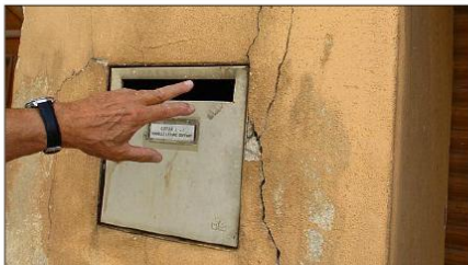
De nombreuses fissures sur les façades des bâtiments sont apparues.
