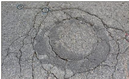
Le bitume de la route endommagé et par endroits affaissé.
