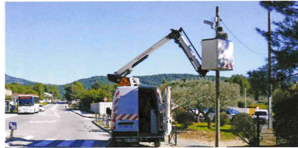
ÉCLAIRAGE DES PASSAGES PIÉTONS
