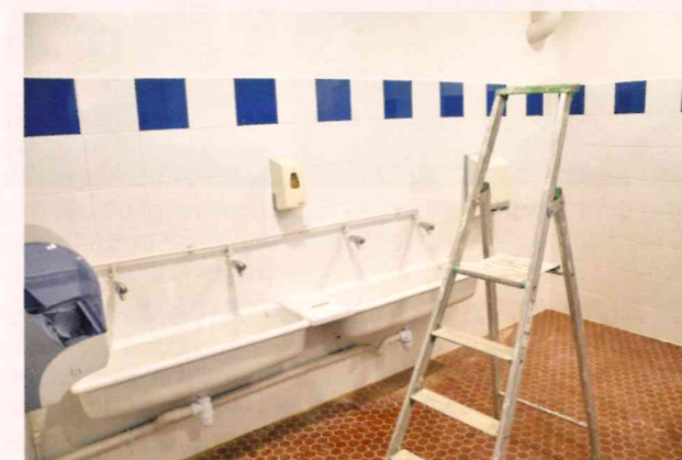
Rénovation des toilettes au sein de la cantine à l'école maternelle : placage des murs pour plus d'hygiène, abaissement des lavabos et mise en place de toilettes bas pour enfants. Propreté en peinture et placage des murs dans les autres pièces (espace des employés + espace restauration)
